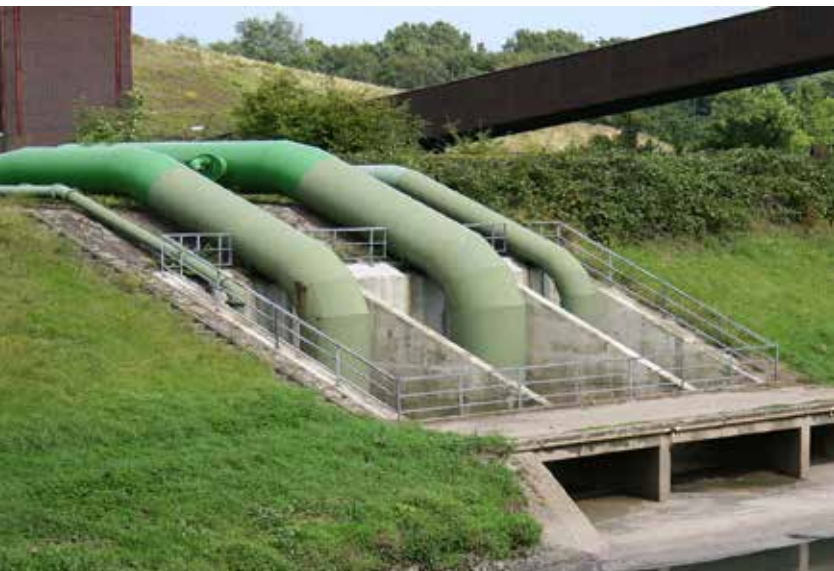
Transporte de aguas residuales en el Emscher Park, Duisburg
